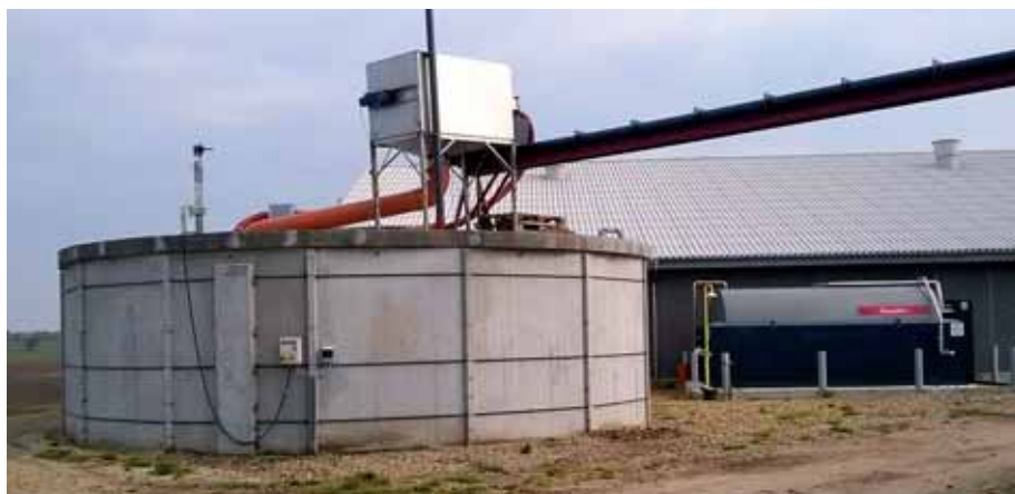
Fot. 2. Zbiornik procesowy z mieszadłem do gnojowicy.
