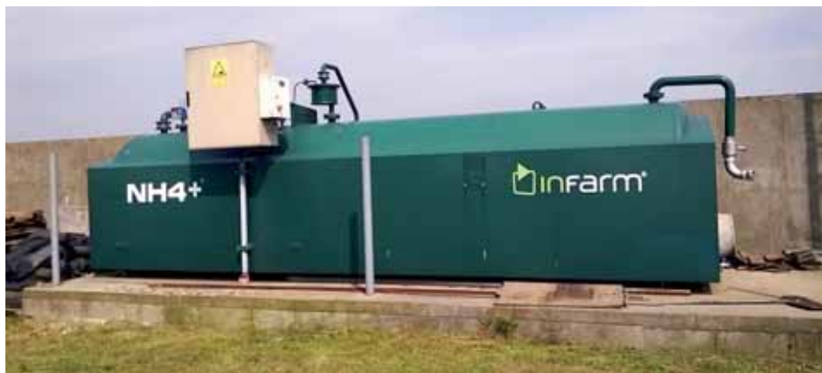
Fot. 1. Zbiornik z kwasem siarkowym do zakwaszania gnojowicy w systemie „in house”.
